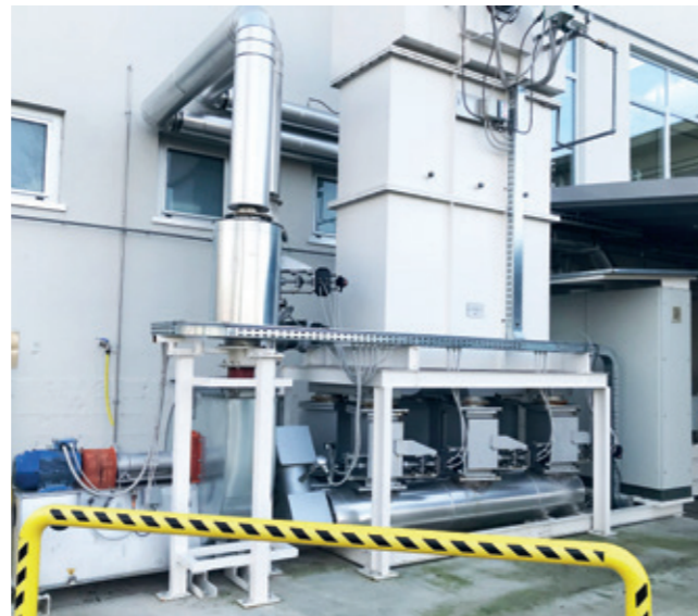
1. Catalyseur et brûleur de fumées. / Catalizador y quemador de humos. 2. R.T.O.
